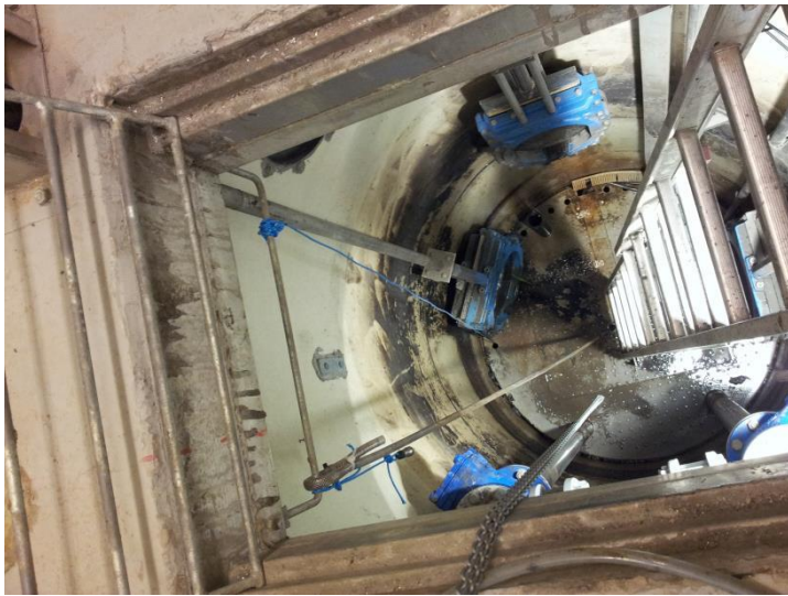
Figur 12: Fra pumpekum PAV. Overløpsrør til Stjørdalselva kan sees øverst til venstre i kummen (svart åpning)
