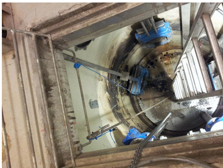
Figur 10: Fra pumpekum PAV. Overløpsrør til Stjørdalselva kan sees øverst til venstre i kummen (svart åpning).
