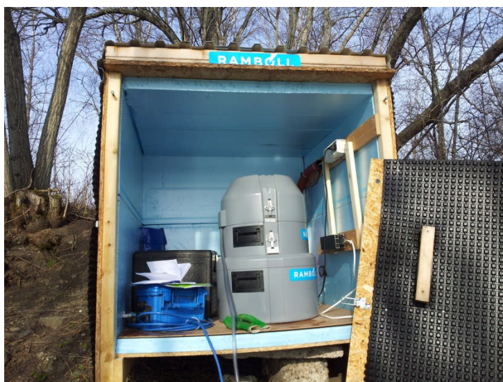
Figur 11: Midlertidig bu for beskyttelse av prøvetaker i utslippspunkt til Stjørdalselva.
