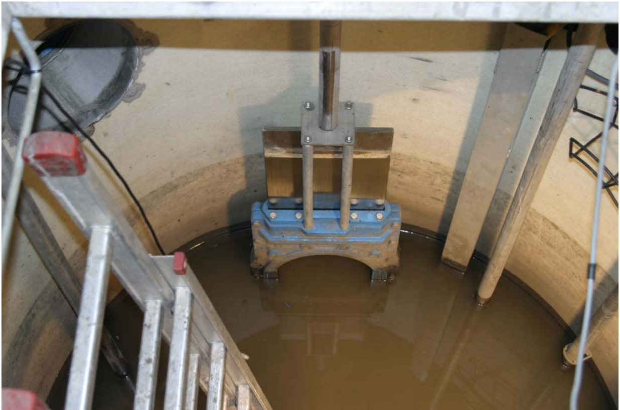
Figur 14. Viser vannstand i pumpekum for oppsamlet glykolholdig vann fra avisingsplattform 14.02.12. Vannstanden står opp til midten av det som tidligere ble antatt å være overløp fra kummen, mens aktuelt rør for overløp ligger høyere oppe (bak stigen).
