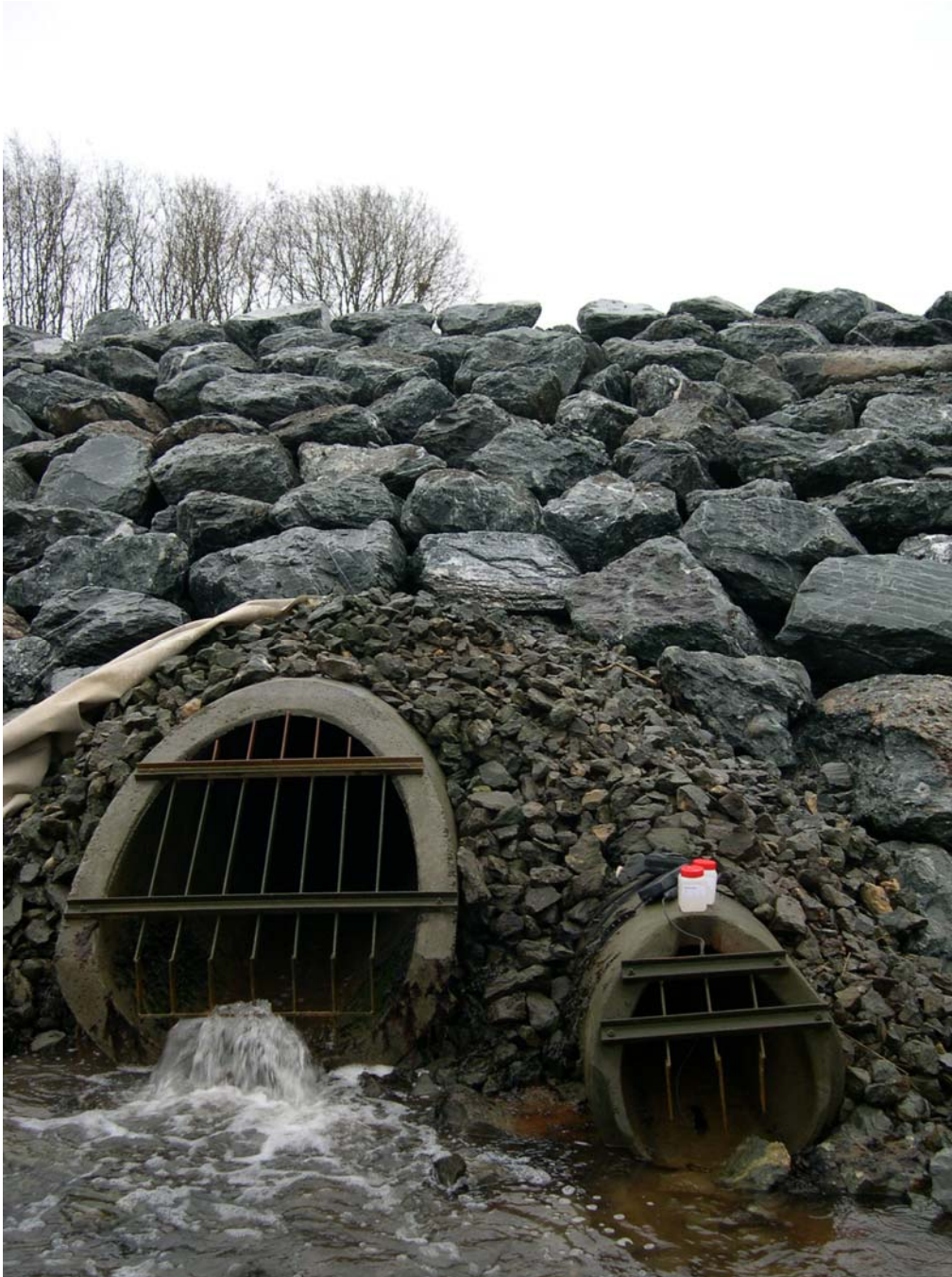
Figur 24. Viser stor (SRGE) og liten (LGE) kulvert etter at disse har blitt forlenget ut i det gamle elveleiet som en del av byggeprosessen for ny E6 i området.
