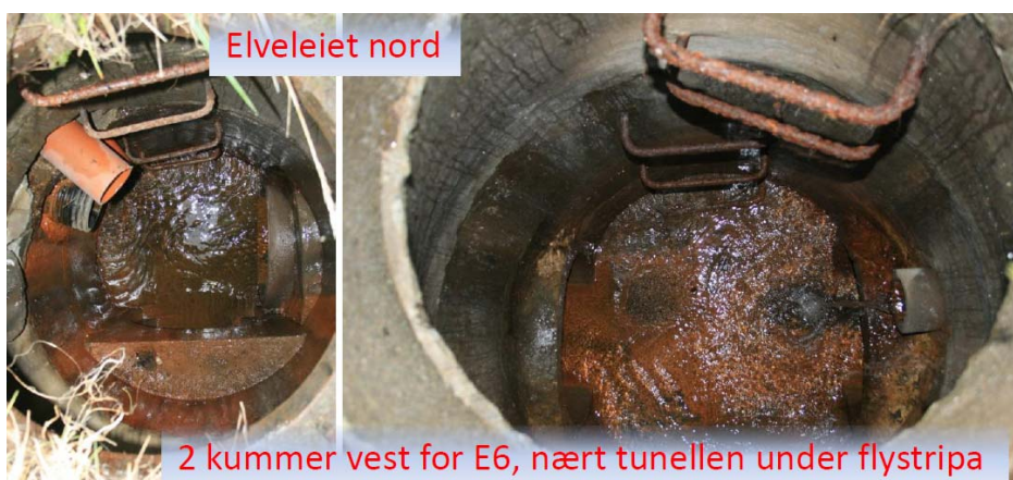
Figur 15. Viser OV1 og OV2 som er inspeksjonskummer for mindre overvanns- og dreneringssystemer langs E6 og flyplassen.
