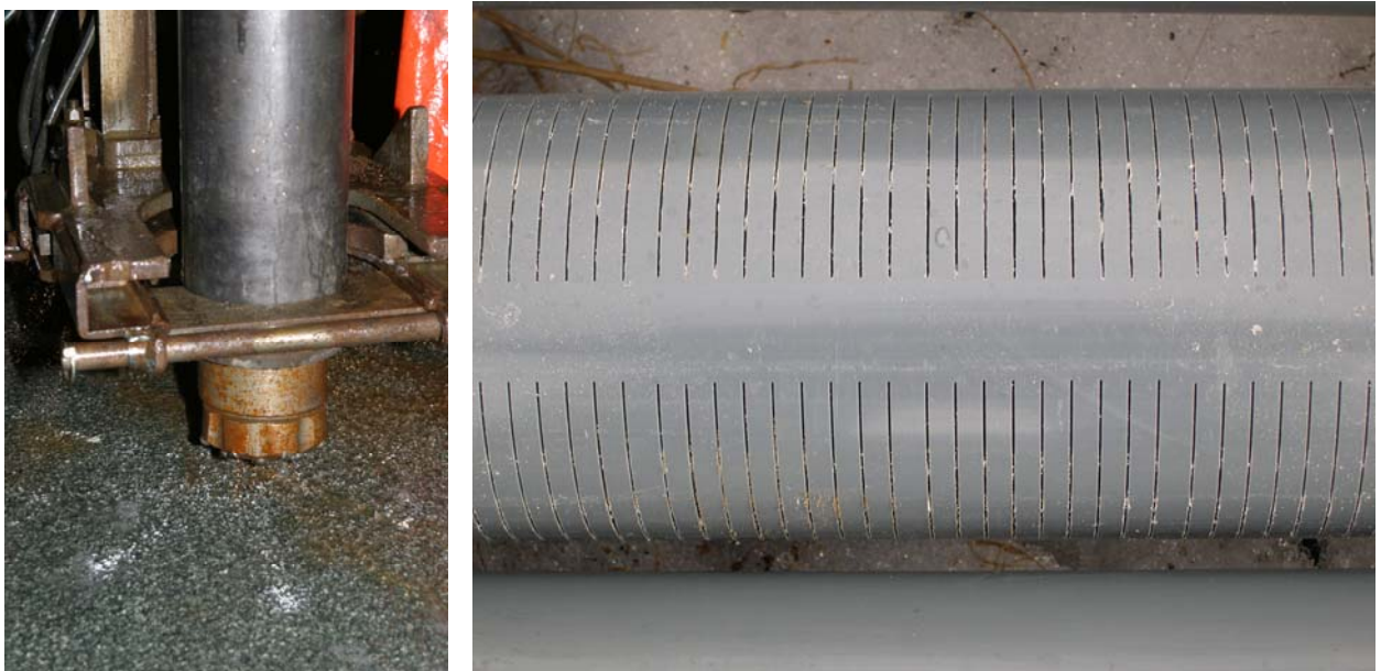
Figur 3. Borkrone ved oppstart av boring MB1 og slisset rør satt ned i miljøbrønnene.
