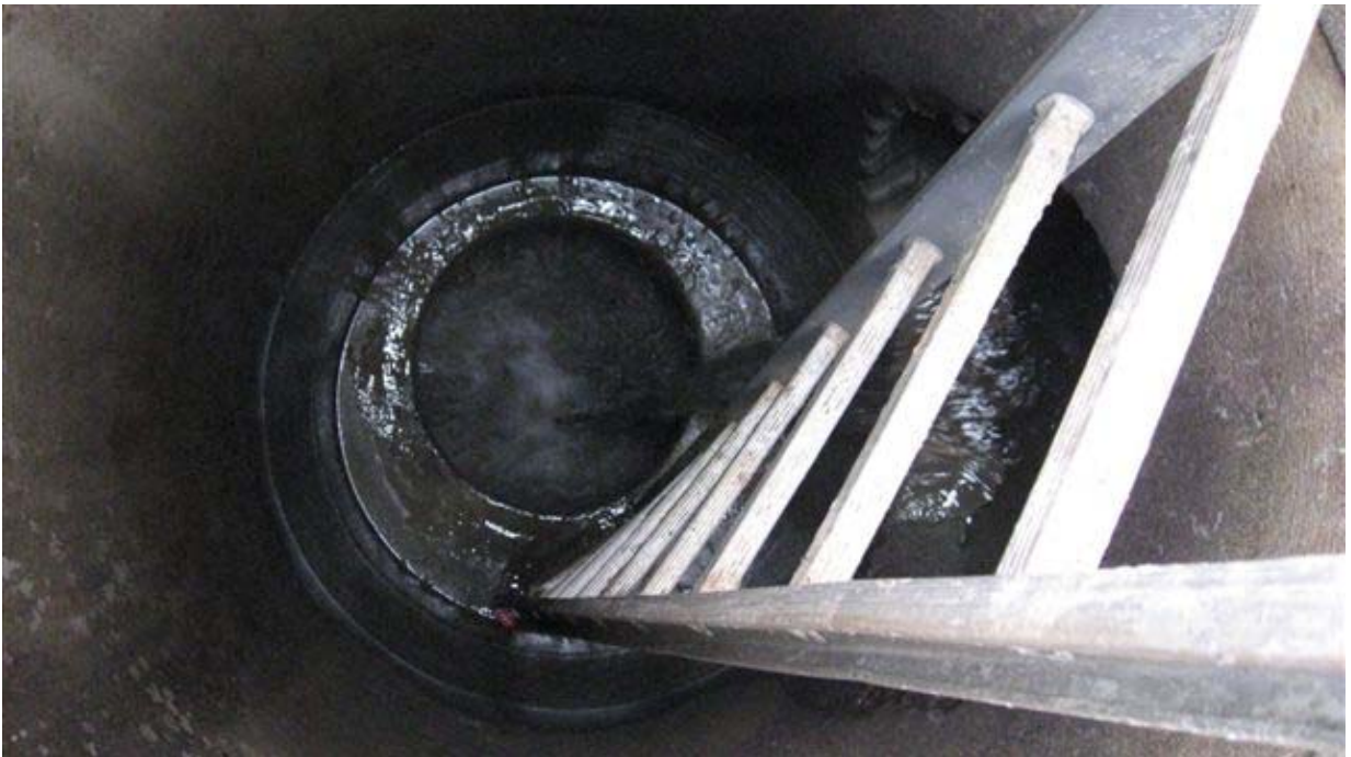
Figur 8. Viser overvannsrør som kommer inn i kum for å falle ned i kulvert for utslipp til elv.
