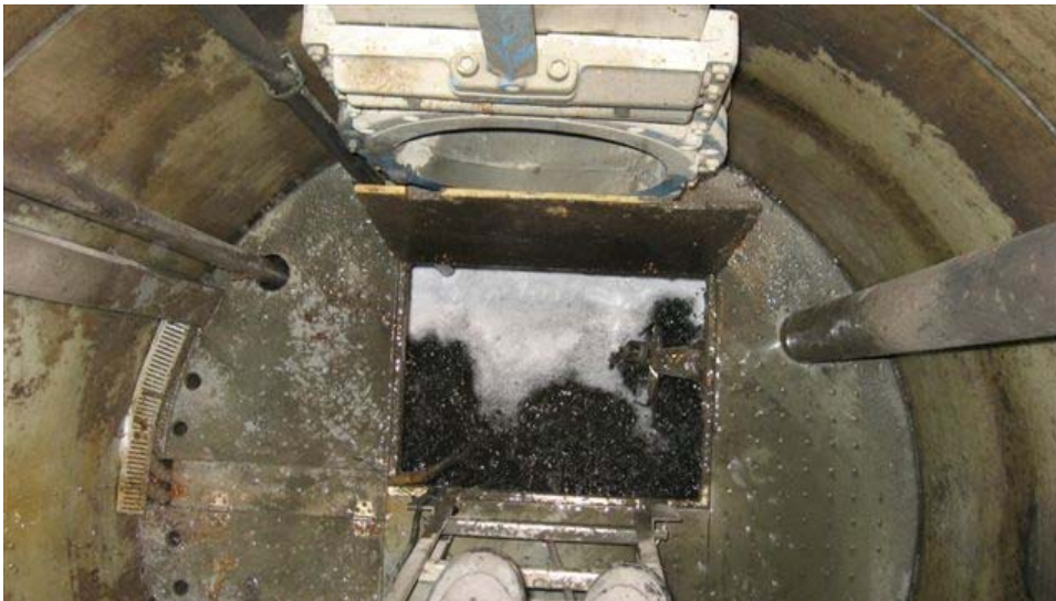
Figur 9. Foto ned i pumpekum for glykolholdig vann. Viser mellomdekk og overløp til Stjørdalselva
