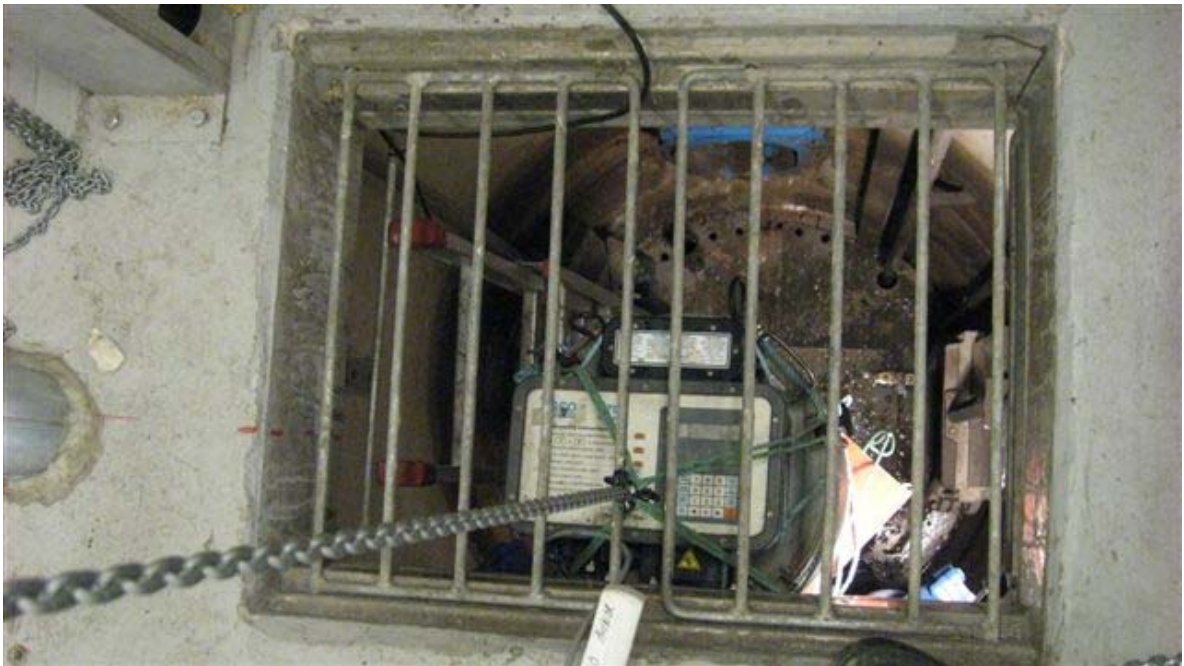
Figur 11. Viser automatisk prøvetaker montert i pumpekum.
