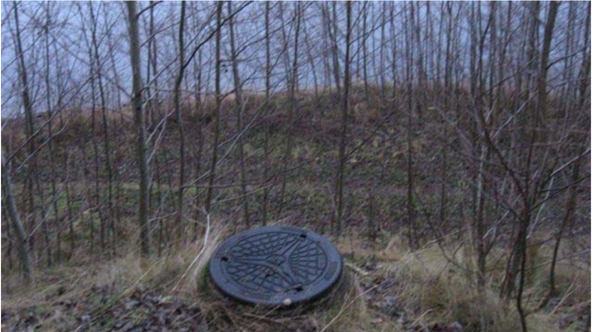
Figur 7. Inspeksjonskum for overvann til Stjørdalselva.
