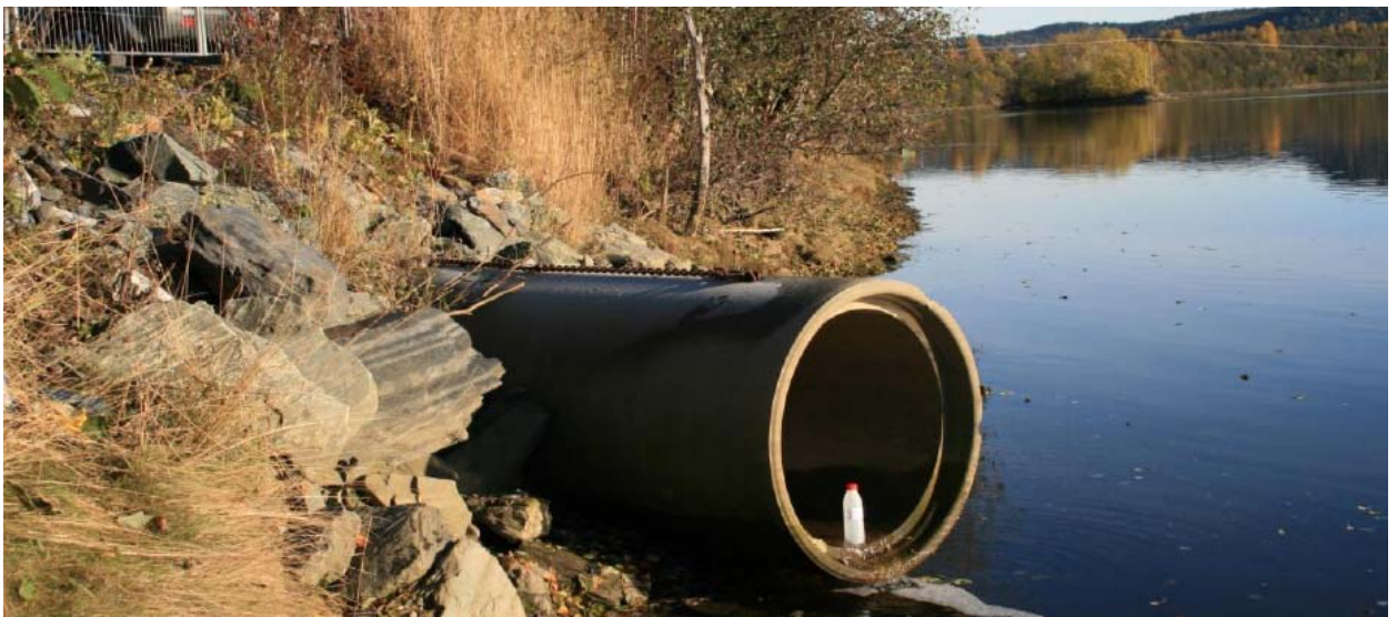
Figur 14. Viser utløpskulvert for åpen grøft hvor det har blitt tatt prøver av utløpsvannet (KUBR).
