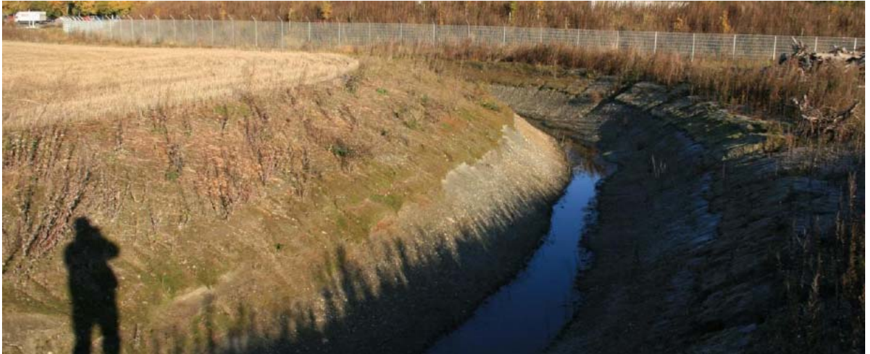
Figur 13. Viser åpen samlegrøft som drenerer grunnvann og overvann i områdene rundt og sør for brannøvingsområdet.
