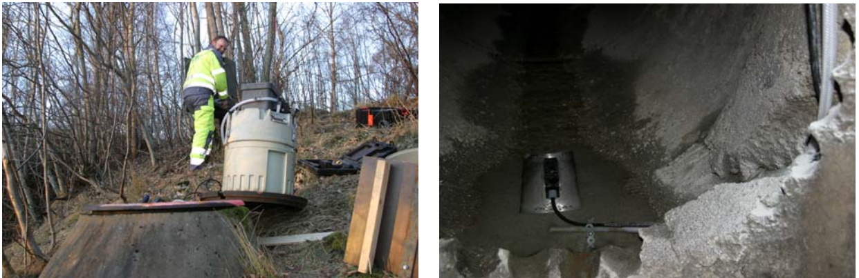
Figur 8. Feltarbeid ved inspeksjonskum for overvann til Stjørdalselva og areal-hastighet sonde for måling av vannføring samt sugeslange for uttak av blandprøve i overvannsrør.
