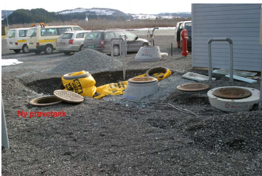
Figur 15. Viser plassering av kum for prøvetaking etter ombygging av renselanlegg.
