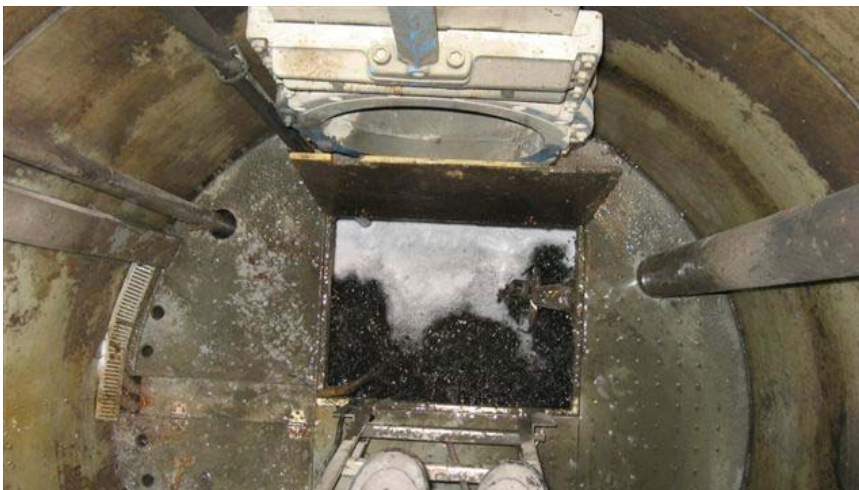
Figur 10. Foto ned i pumpekum for glykolholdig vann. Viser mellomdekk og overløp Stjørdalselva.
