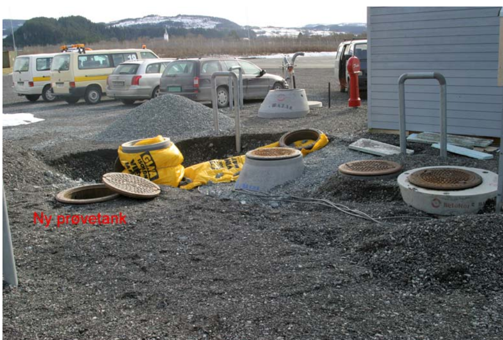
Figur 15. Viser plassering av kum for prøvetaking etter ombygging av renseanlegg.
