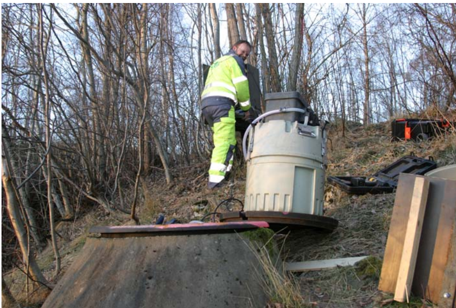
Figur 8. Feltarbeid med henting av vannføringsdata og uttak av vannprøve ved inspeksjonskum for overvann til Stjørdalselva sesongen 07/08.
