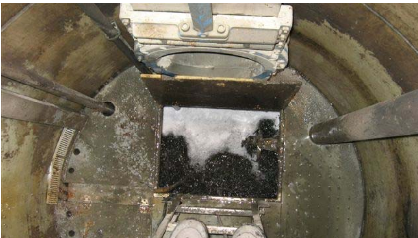
Figur 10. Foto ned i pumpekum for glykolholdig vann. Viser mellomdekk og overløp Stjørdalselva.
