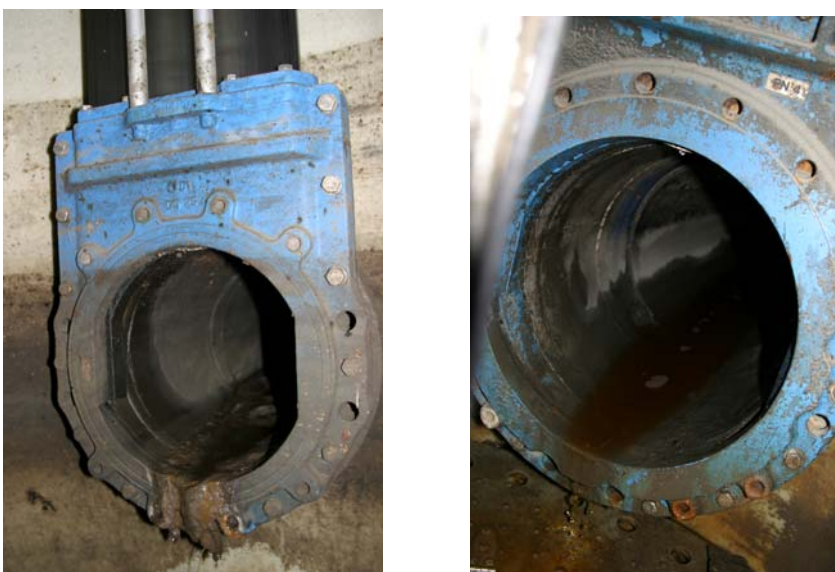
Figur 11. Viser overløpsrør til Stjørdalselva ved to feltbesøk sesongen 07/08.
