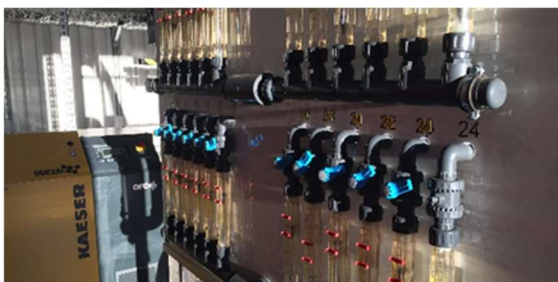
Styring av innblåsing av luft.
